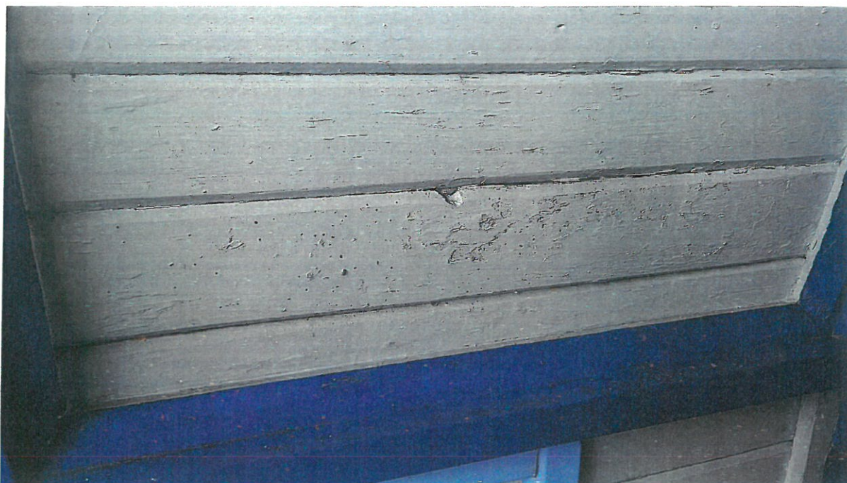
Zdj. 22 – Podbitka, widoczna działalność kornika
