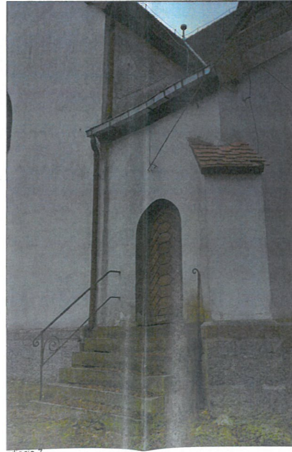
zdjęcie 7. narożnik północno-zachodni budynku widoczne wiatrownice z blachy przeznaczone do rozbiórki i orynnowanie przeznaczone do wymiany
