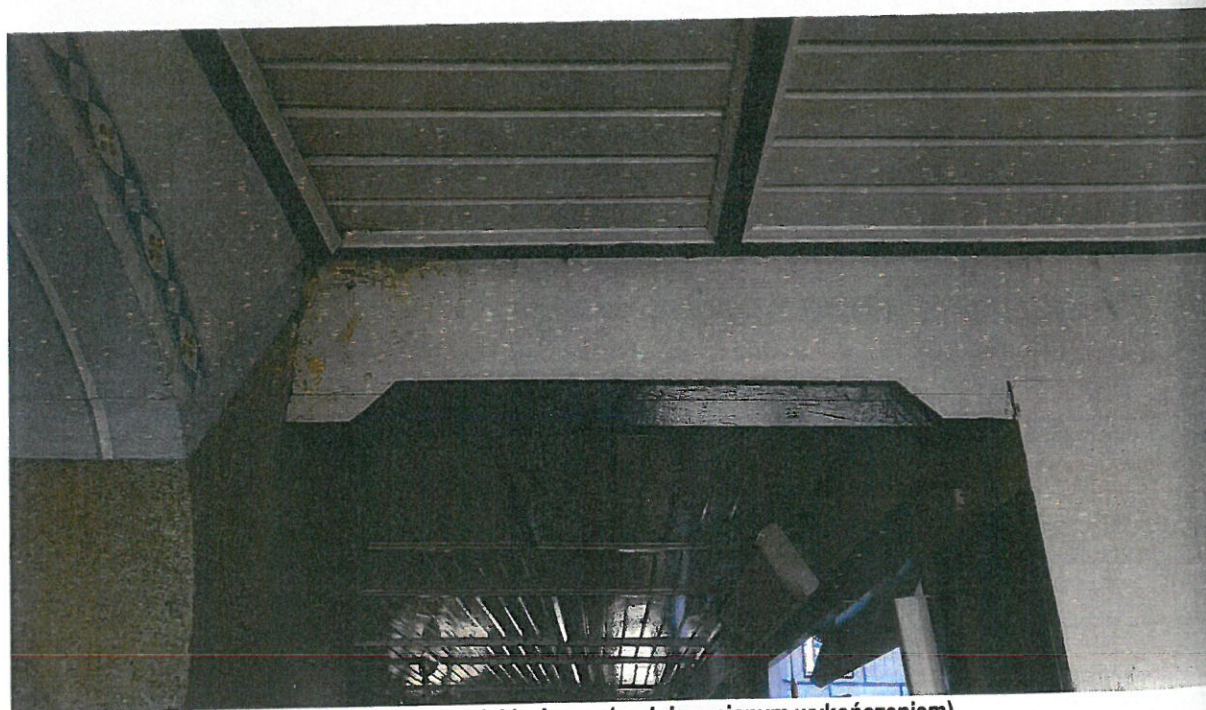
Zdj. 8- widoczne zacieki z kosza (pod drewnianym wykończeniem)
