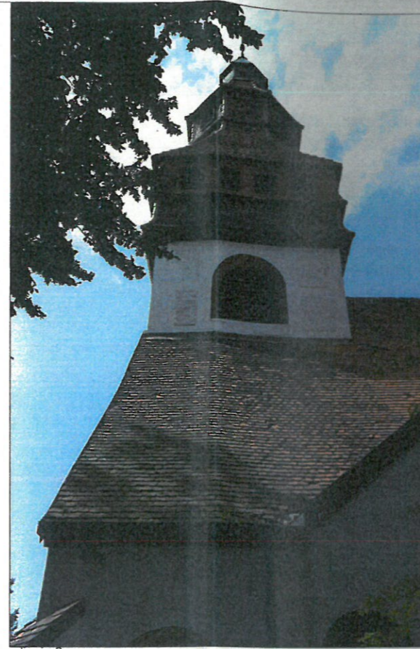
zdjęcie 3. połacie wschodnia przy wieży widoczny zły stan pokrycia dachowego oraz wiatrownice z blachy przeznaczone do rozbiórki i orynnowanie przeznaczone do wymiany
