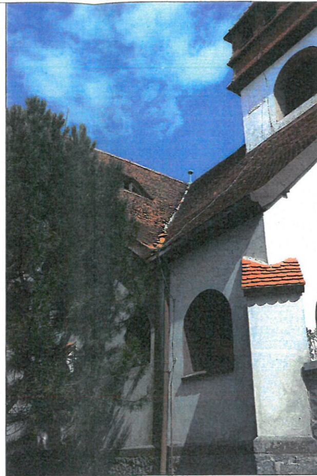
zdjęcie 2. połacie południowo-zachodnie widoczny zły stan pokrycia dachowego oraz wiatrownice z blachy przeznaczone do rozbiórki i orynnowanie przeznaczone do wymiany
