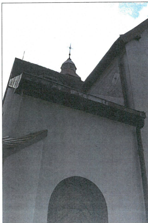
zdjęcie 5. narożnik północno-wschodni widoczne wiatrownice z blachy przeznaczone do rozbiórki i orynnowanie przeznaczone do wymiany
