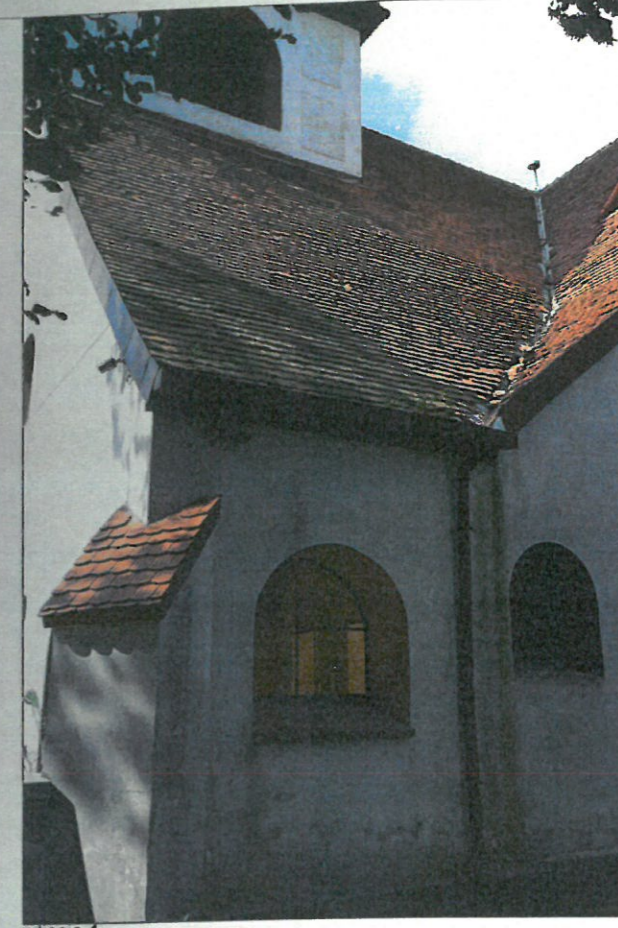
zdjęcie 4. połacie południowo-wschodnie widoczny zły stan pokrycia dachowego oraz wiatrownice z blachy przeznaczone do rozbiórki i orynnowanie przeznaczone do wymiany
