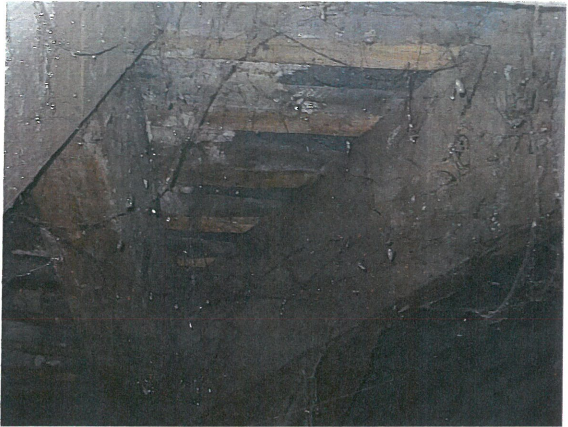
Zdj. 16 widoczne zacieki na łatach przy koszu
